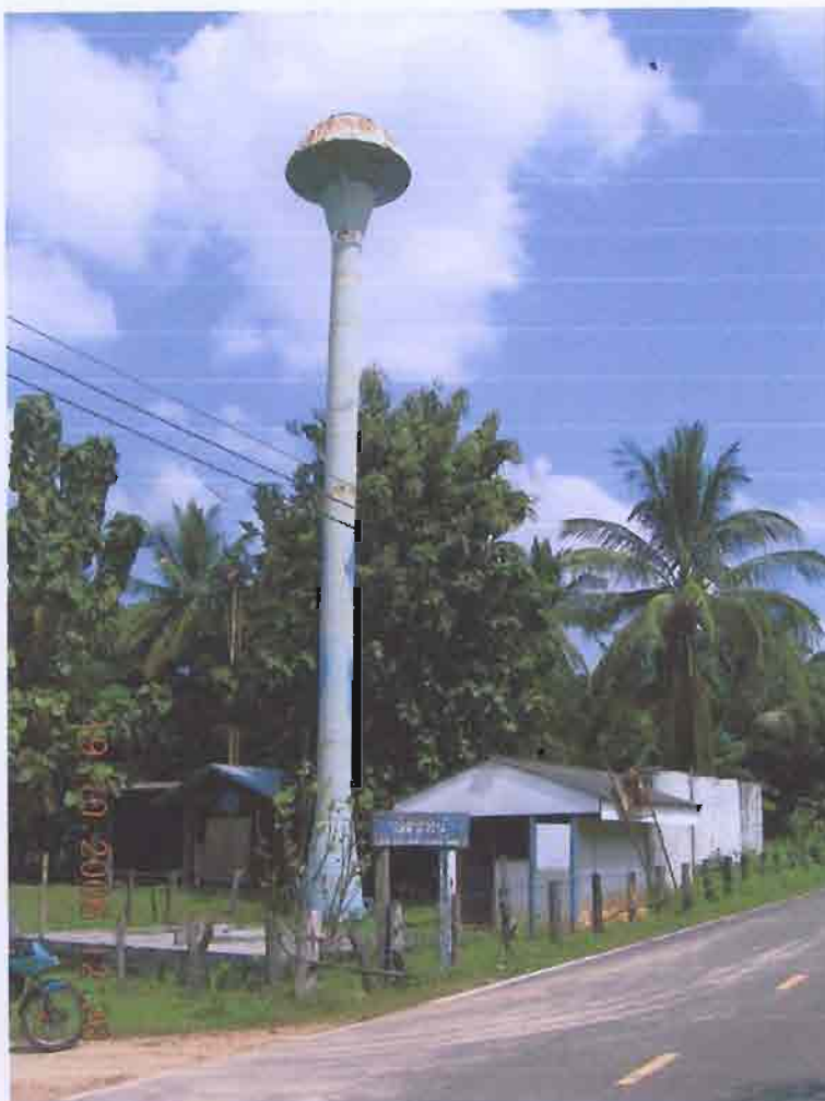
ถังพักน้ำที่สูบน้ำมาจากเครื่องสูบน้ำที่ใช้ ระบบแอร์แวนช่วยเพิ่มแรงดันน้ำ
