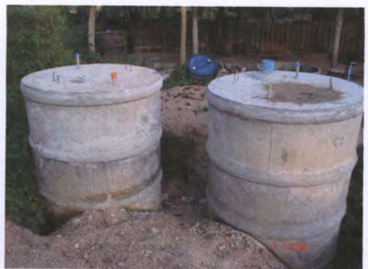
ถังผลิตแก๊สชีวภาพแบบคอนกรีต
