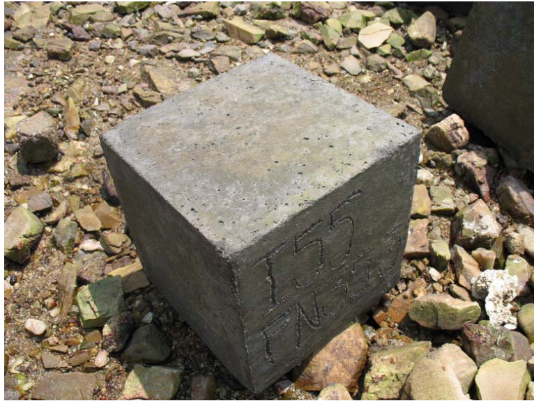
(ก) สี่คอนกรีต และสภาพการสึกกร่อนเนื่องจากแรงกระแทกของคลื่น
