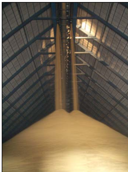
รูปที่ 4.9 การลำเลียงน้ำตาลเข้าคลังสินค้าแบบเทกองโดยใช้สายพานลำเลียง
