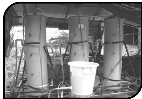
ระบบ AD ที่ติดตั้ง ณ สหกรณ์โรงอบ/รมยาง
