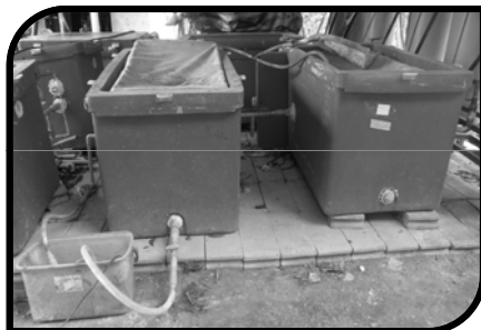
ระบบ AL ที่ติดตั้ง ณ สหกรณ์โรงอบ/รมยาง
