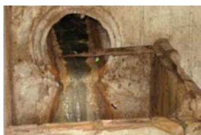
ท่อระบายน้ำเสียของโรงนม
