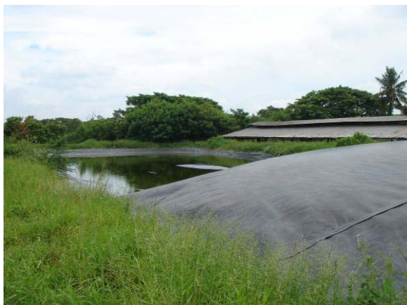
Biogas ชนิด cover lagoon
