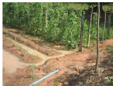
ภาพที่ 15 ระบบท่อส่งน้ำไปตามที่ลุ่ม
