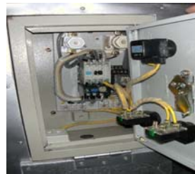
รูปที่ 2 อุปกรณ์ภายในตู้ควบคุม
