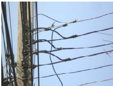
รูปที่ 2 การใช้ข้อรัดสายไฟฟ้าแบบพีจีในระบบจำหน่าย
