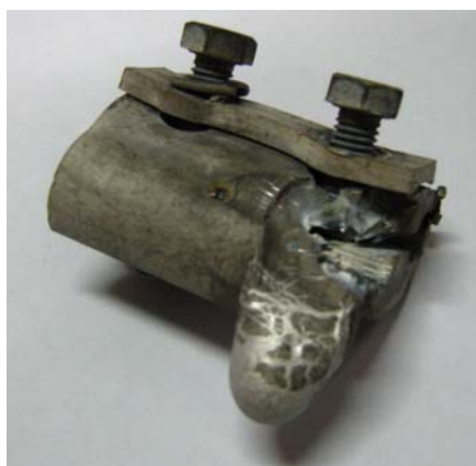
รูปที่ 9 ขั้วลวดสายไฟฟ้าที่ชำรุดเสียหายเนื่องจากความร้อน
