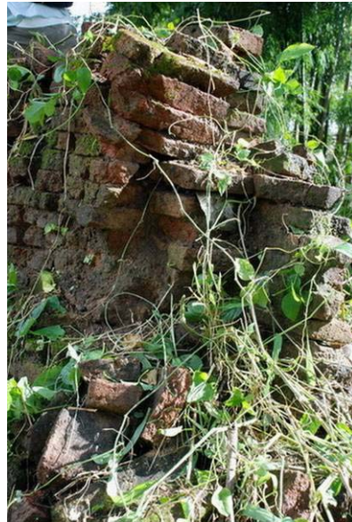
รูปที่ ข.521 สภาพมูมแนวอิฐด้านทิศเหนือ มีลักษณะคล้ายการย้อมุม
