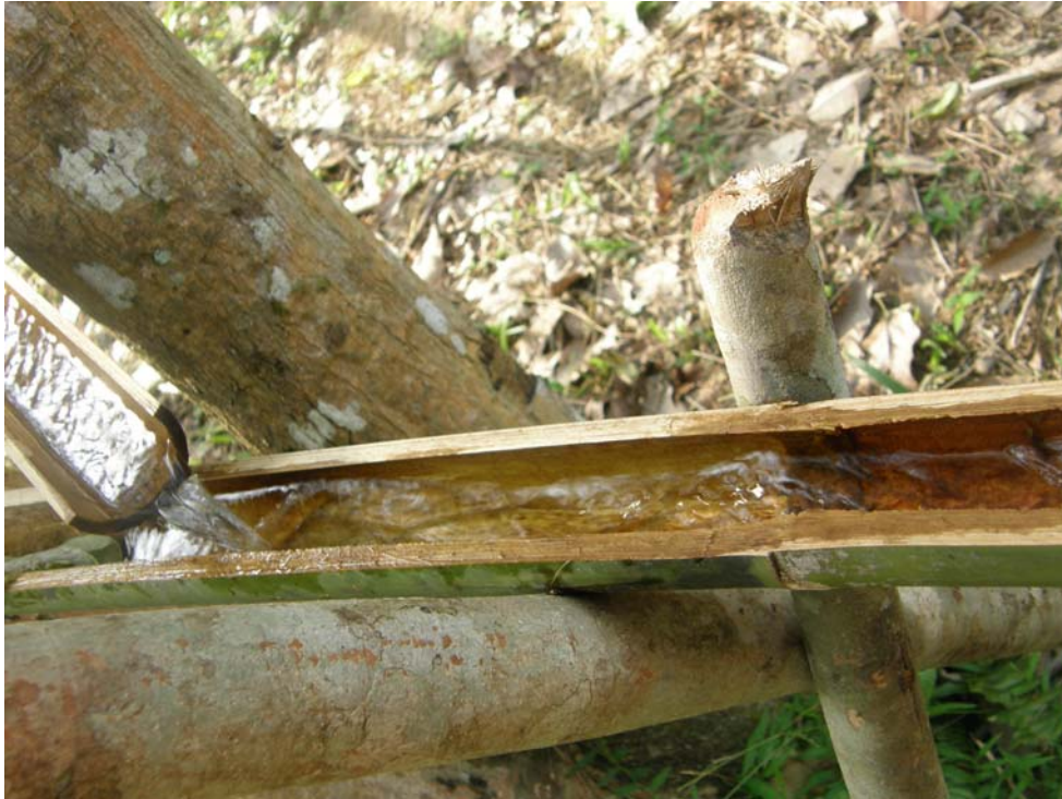
ท่อประปาทำจากไม้ไผ่เพื่อนำน้ำร้อนจากแหล่งกำเนิดมาบริการนักท่องเที่ยวในห้องอาบน้ำของชุมชน
