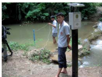
รูปที่ 9 การเดินสายสัญญาณจากอุปกรณ์ตรวจวัดระดับน้ำมายังภาคส่งของเครื่องเตือนภัยน้ำป่าไร้อายุจริยะ
