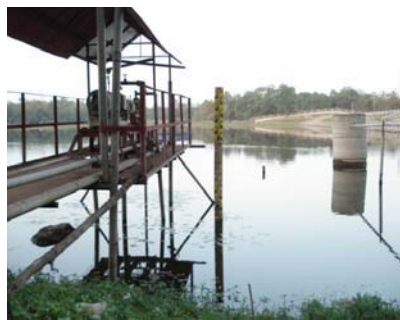
(2) บริเวณใต้เครื่องสูบน้ำ
