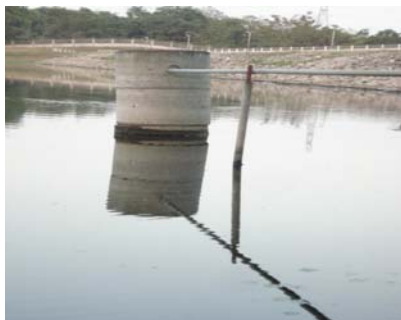
(1) บริเวณท่อดูดน้ำ
