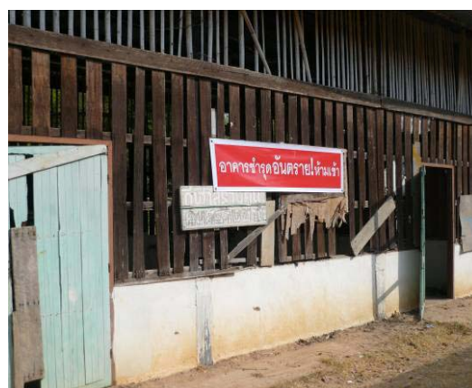
รูปที่ 4 การตีตปัายเตื่อนอันตรราย
