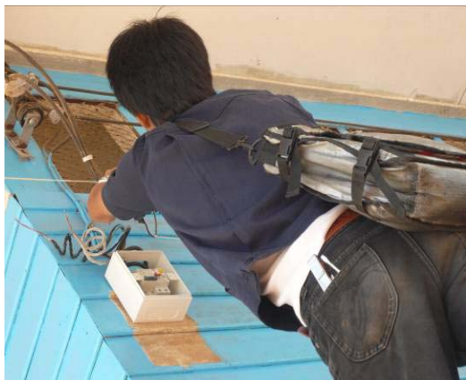
รูปที่ 2 การซ่อมแซมอุปกรณ์ไฟฟ้าและติดตั้งเครื่องตัดไฟ
