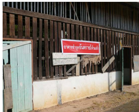
รูปที่ 4 การติดป้ายเตือนอันตราย
