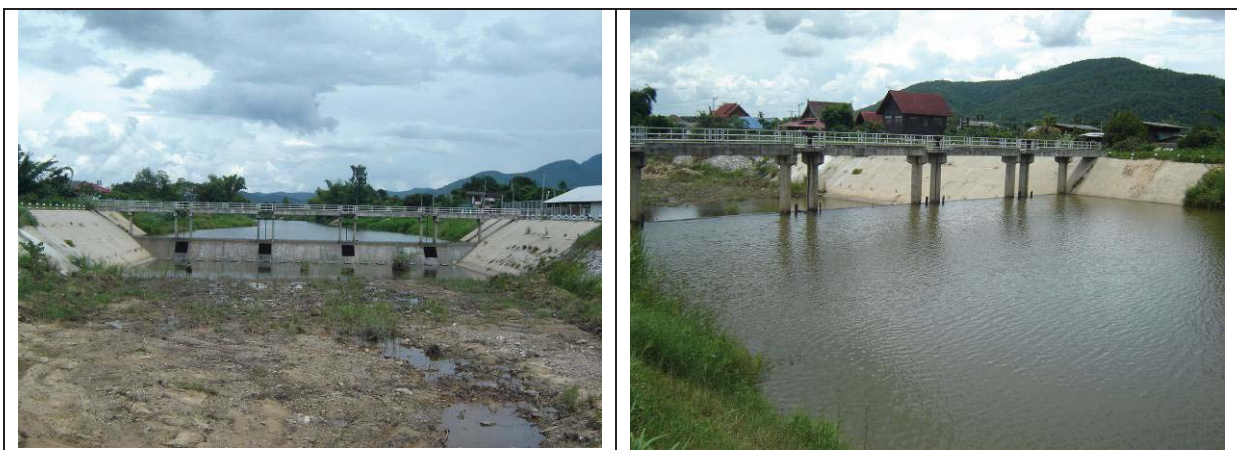
ฝายคอนกรีตในพื้นที่ลุ่มน้ำท่าตอนปลาย
