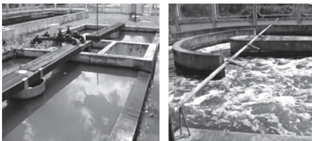
รูปที่ 4 ระบบบำบัดน้ำเสียโรงพยาบาลสว่างแดนดิน จังหวัดสกลนคร
