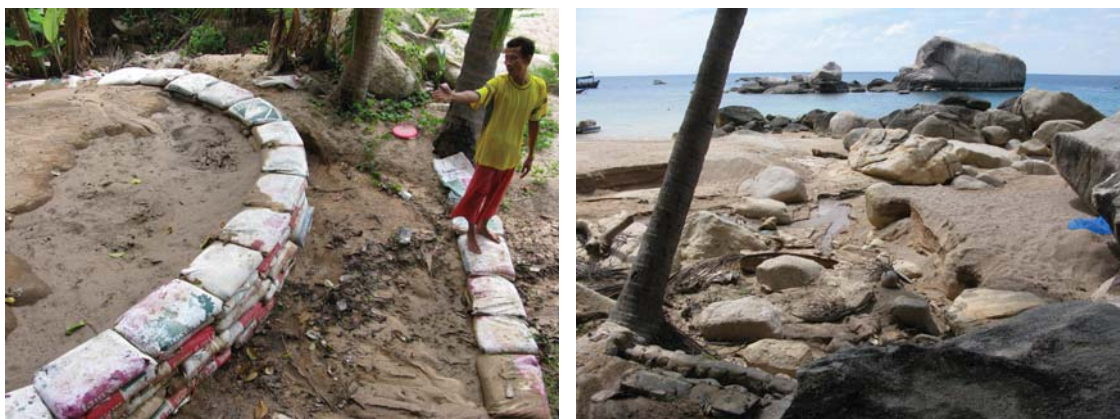
ภาพที่ 1.1-3 : สภาพของเขื่อนกันโคลนชั่วคราวและพื้นที่บริเวณชายหาด
