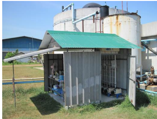
ภาพที่ 3.11 อาคารติดตั้งระบบดูดซึมทางเคมี และระบบกรองชีวภาพ
