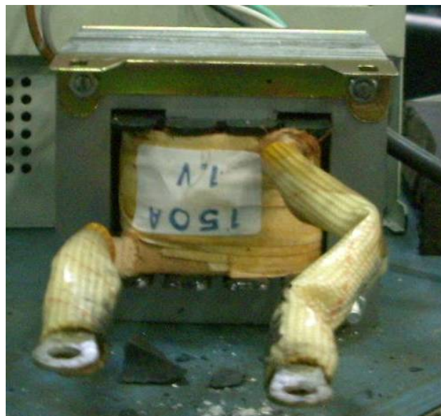
รูปที่ 24 หม้อแปลง ขนาด 1V 150A
