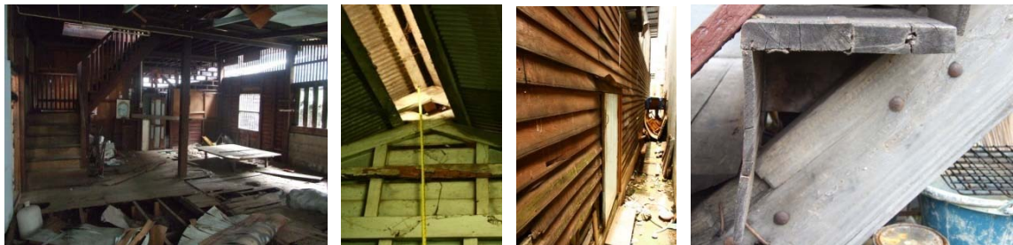
ภาพที่ 3-81 อาคารพื้นถิ่น ที่มีสภาพเสื่อมโทรมและการผุพังของโครงสร้าง
