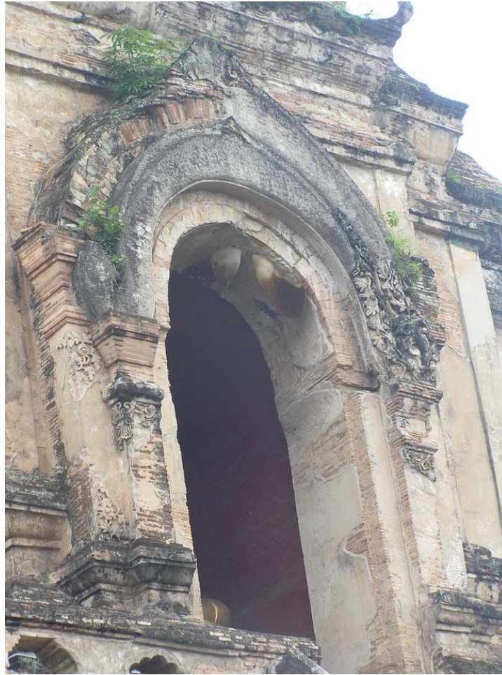
ลวดลายปูนปั้นประดับซุ้มจระนำด้านทิศเหนือเจดีย์หลวง คงเหลือปูนปั้นเพียงส่วนปลายซุ้มวงโค้งของจระนำ และบางส่วนของกาบบน และกาบล่าง
