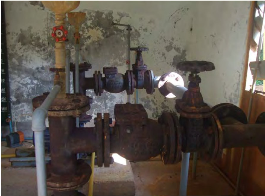
รูปที่ 79: ปั๊มน้ำ
