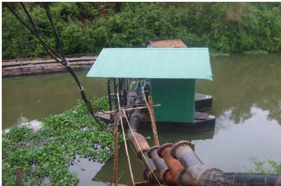
รูปที่ 87: สถานีเครื่องสูบน้ำด้วยไฟฟ้า ระบบคลองส่งน้ำเพื่อการเกษตร
