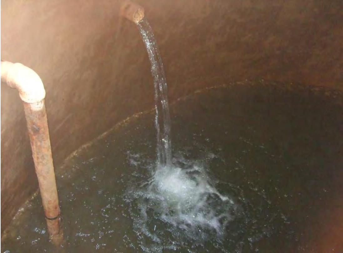
รูปที่ 9: ถังพักน้ำที่หลังจากการกรองในขั้นตอนร่อนน้ำวนก่อนการส่งไปผ่านคลอรีนและสารส้ม ก่อนถูกส่งไปยังถังพักน้ำใหญ่ชั้นล่าง
