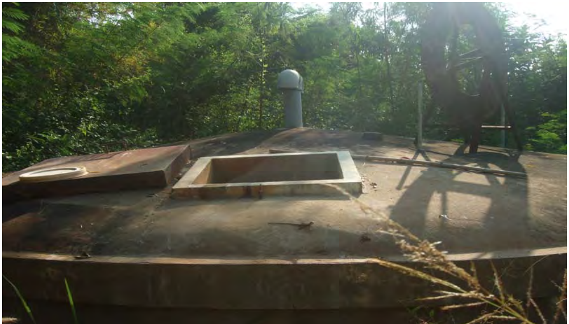
รูปที่ 10 : บ่อพักน้ำก่อนจะส่งน้ำที่สะอาดแล้วลงสู่บ่อพักน้ำ ถังเก็บน้ำขนาดใหญ่นี้จะฝังตัวในดินข้างล่าง
