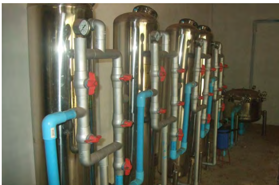
รูปที่ 81: ระบบกรองน้ำประปาบาดาลที่วัดป่าเทพพิทักษ์
