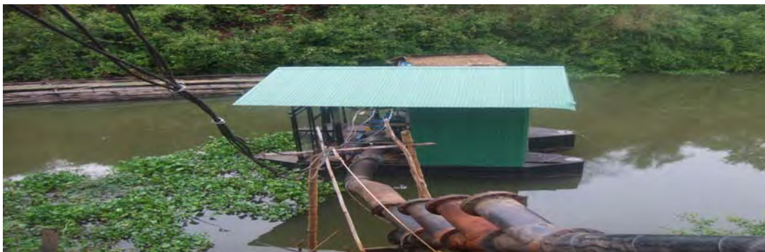
รูปที่ 54: สถานีสูบน้ำด้วยไฟฟ้า “ท่าชีควาย”
