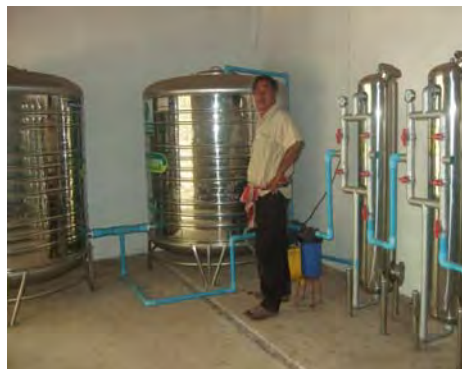
รูปที่ 83: ถังกรองน้ำ
