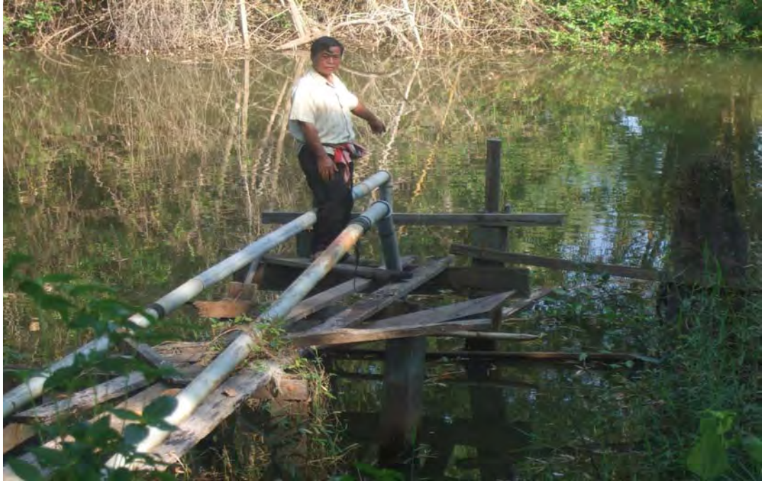
รูปที่ 1: จุดที่หัวกะโหลกท่อประปาอยู่ใต้น้ำที่กุดน้ำใส
