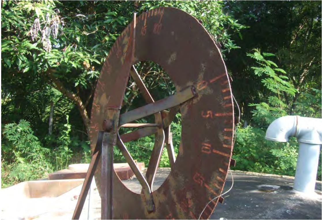
รูปที่ 11 : เข็มวัดระดับน้ำที่ถั่งไต่ดินซึ่งปัจจุบันชำรุดใช้การไม่ได้
