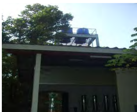
รูปที่ 82: หอถังพักน้ำที่บรรจุที่ 8,000 ลิตร
