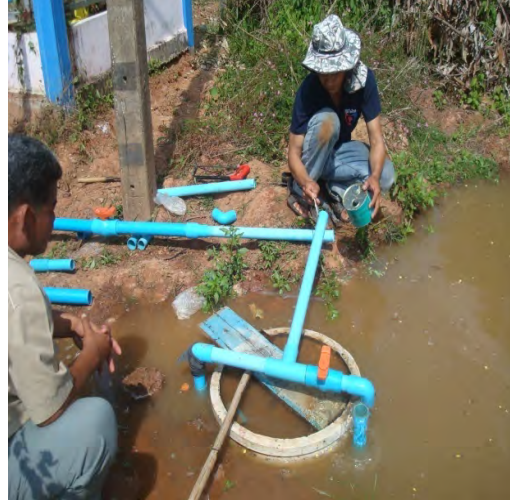
รูปที่ 43: จุดเชื่อมต่อส่งน้ำประปาโรงเรียน
