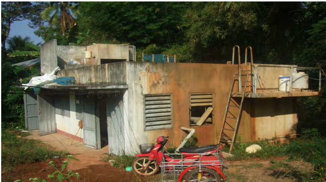
รูปที่ 12: ตัวอาคารเก็บระบบกรองซึ่งประกอบด้วยไต้ปั่นน้ำ กรองคลอรีน สารส้ม
