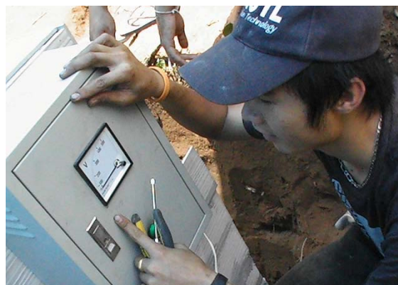
รูปที่ 228 หน้าปัดมิเตอร์วัดแรงดันไฟฟ้าก่อนวงล้อ หมุน
