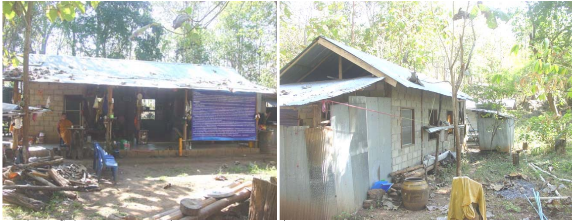
ภาพที่ 4.10 พื้นที่อาคารสำนักสงฆ์เดิมที่มีความทรุดโทรมควรรย้ายที่และปรับเป็นอาคารนิทรรศการ
