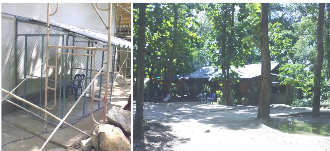
ภาพที่ 5.4 การต่อเติมอาคารโดยไม่ได้ออกแบบไว้แต่ต้น และอาคารสำนักสงฆ์เดิม ที่ควรได้รับการปรับปรุงให้ดีขึ้น
