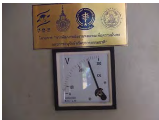
เครื่องกำเนิดไฟฟ้าพลังน้ำ จ่ายไฟฟ้าเข้าระบบ
