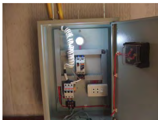
เครื่องกำเนิดไฟฟ้าพลังน้ำ ชุดควบคุม ระบบการจ่ายไฟฟ้าแสดงให้เห็นแสงสว่าง
