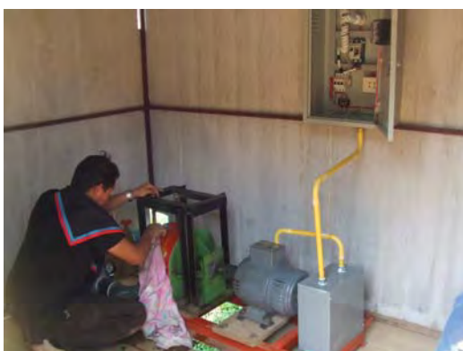
กักกั้นน้ำถูกต่อเข้ากับระบบท่อส่ง เพื่อขับ กักกั้นน้ำ ผลิตไฟฟ้า
