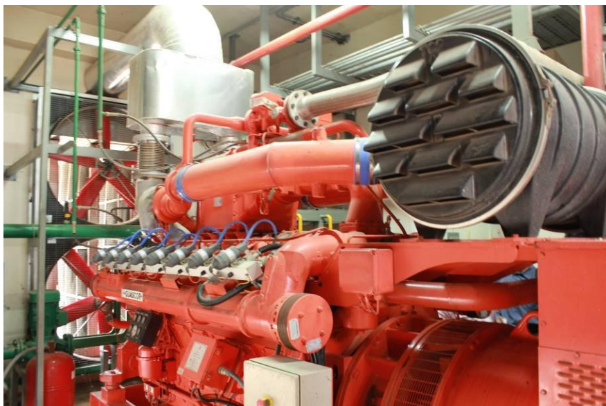
ภาพที่ 3.9 เครื่องกำเนิดไฟฟ้าที่ได้จากการผลิตก๊าซชีวภาพ
