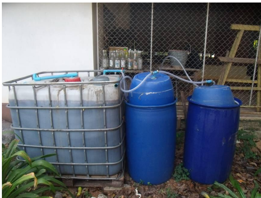
ภาพที่ 3.29 ถังก๊าซชีวภาพที่ติดตั้งและใช้งานในโรงเรียนบ้านเปร็ดโน
