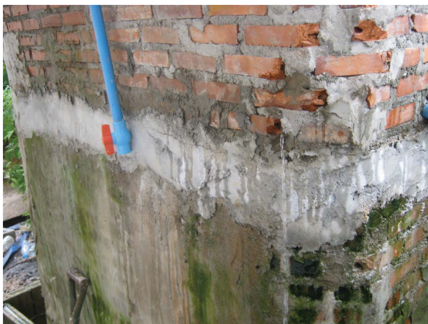
รูปที่ 3.18 การรั่วซึมที่เกิดขึ้นหลังจากก่อสร้างแล้วเสร็จ 2 สัปดาห์
