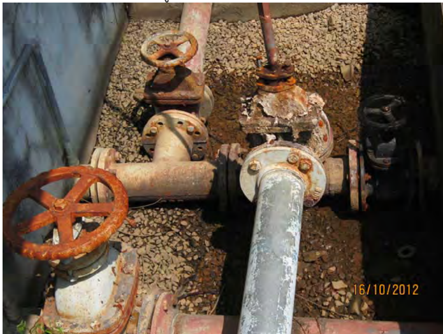
ภาพท่อส่งน้ำในการผลิตน้ำประปาที่ไม่ได้รับการบำรุงรักษาอย่างต่อเนื่อง
