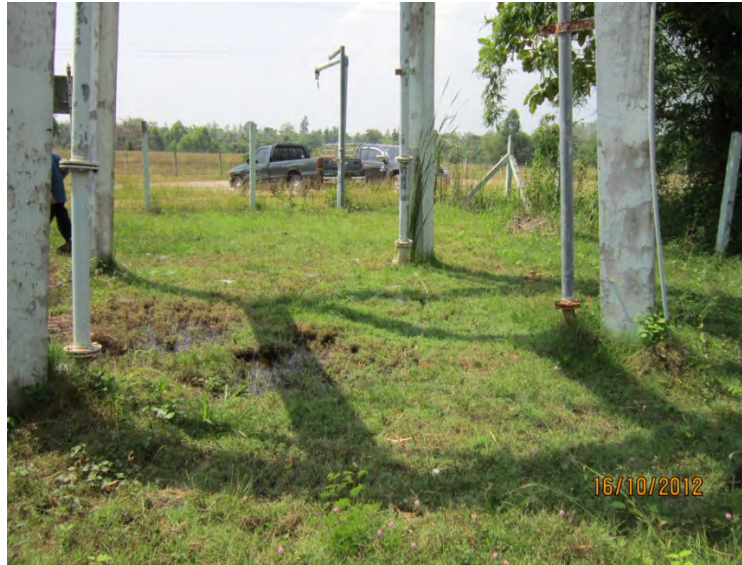
ภาพท่อน้ำจากหอสูงรั่วอย่างเห็นได้ชัด
