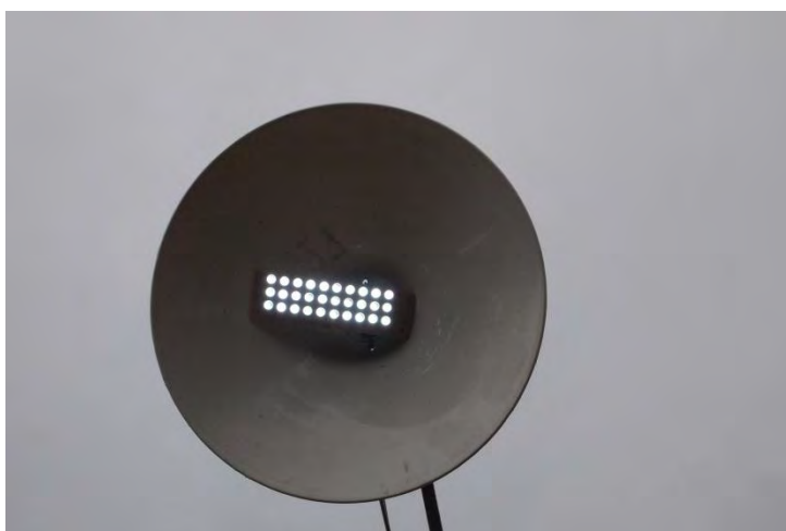
โคมไฟแสงสว่าง ตามทางเดินสาธารณะทั้งหมู่บ้านที่ติดตั้งใช้งาน
