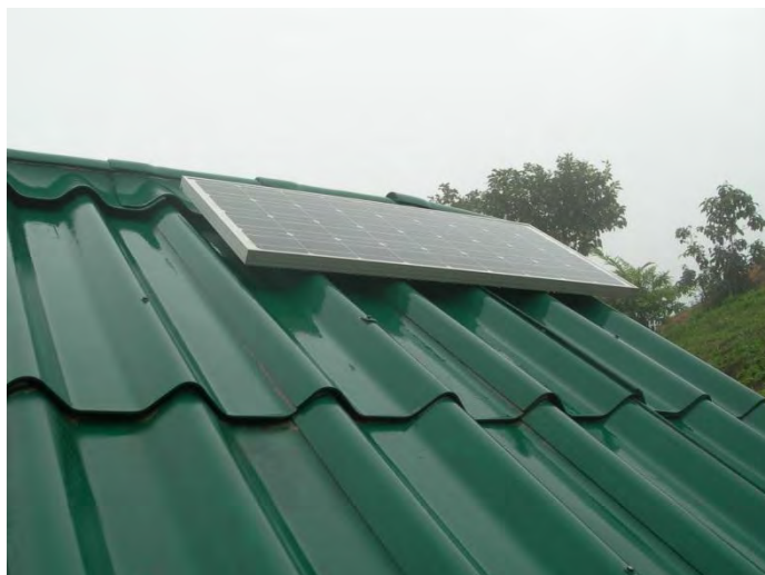
โซลาเซลล์ที่ติดตั้งบนหลังคาเบิร์ม ณ ฐานปฏิบัติการช่องทางนาป่าแปก
