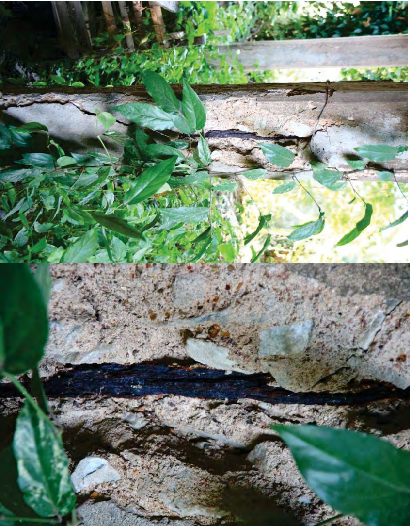
ภาพที่ 3.99: รูปแบบการเสริมไม่แข็งแรงในเสาอาคารพักอาศัยชั้นใต้ดินตำบลแม่เมาะ ที่มา : การวิเคราะห์และสำรวจอาคาร บ้านนางภาวิณี ชื่นรัฐ
