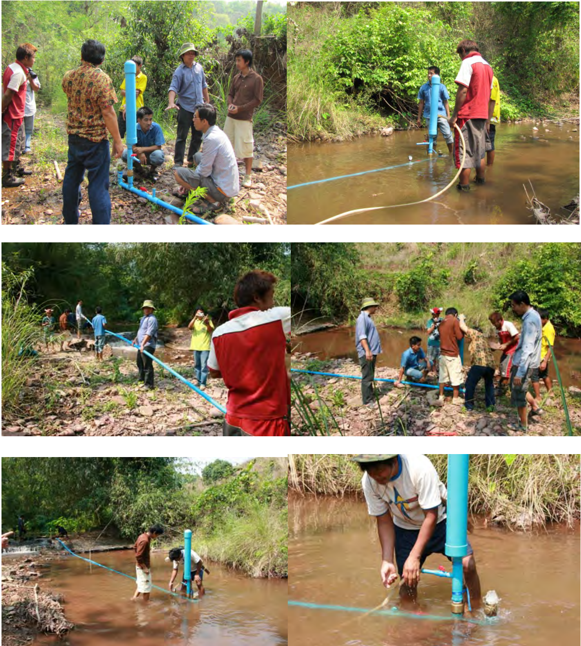
สาธิตการประกอบและการทำงานของปั้มน้ำกระแทก
