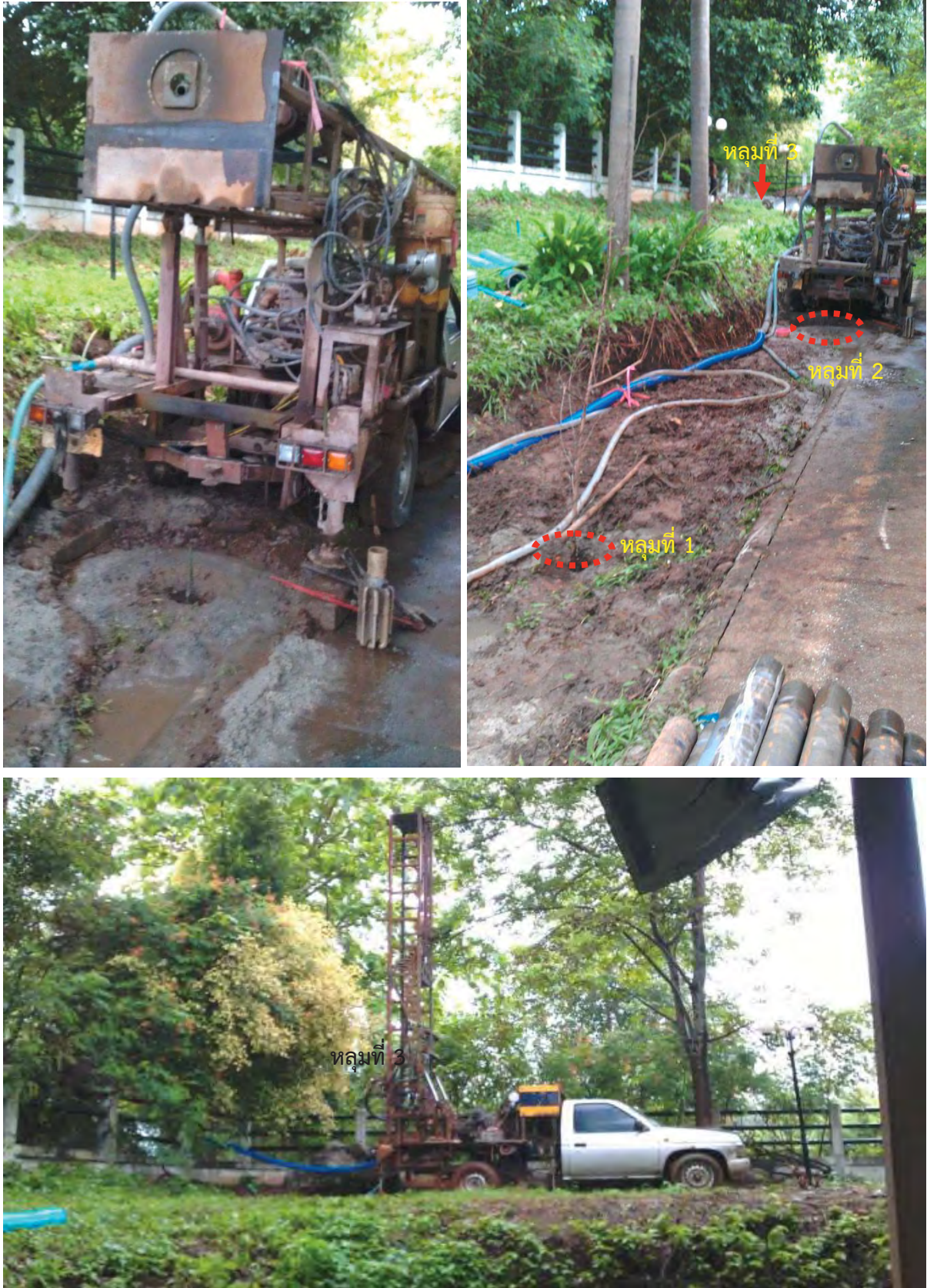
ภาพที่ จ ตำแหน่งการจุดเจาะน้ำใต้ดินทั้งหมด 3 ตำแหน่งและการวางเครื่องเจาะซึ่งจุดเจาะที่ 3 มีการ ขยับเปลี่ยนตำแหน่งหลายครั้งเนื่องจาก พบชั้นตะกอนเศษหินเชิงเขาไม่สามารถเจาะต่อได้
