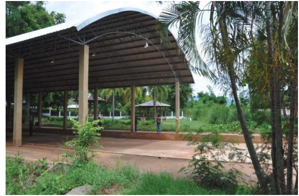
ภาพที่ 4-44 สภาพสิ่งปลูกสร้างที่ถูกทิ้งร้าง
