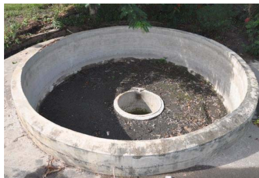
ภาพที่ 4-69 สภาพบ่อน้ำร้อน (เดิม) ปัจจุบัน เสื่อมสภาพแล้ว
