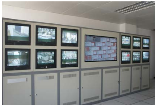
ห้องควบคุม
