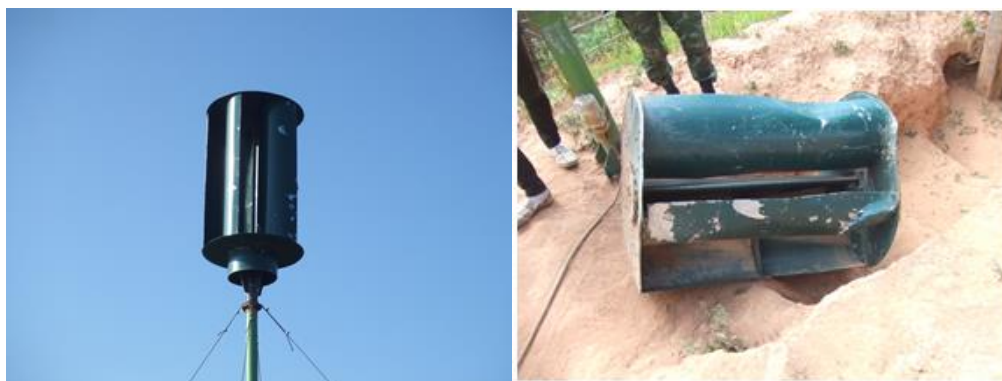
ภาพที่ 3-12 กังหันลมแนวตั้งบนฐานปฏิบัติการดอยหัวแหวน และสภาพที่ขาดจากแรงลม
