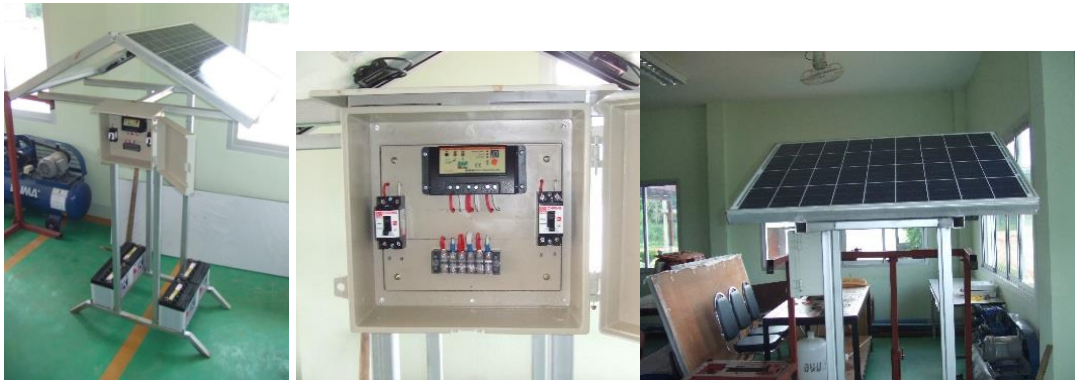
ภาพที่ 3-30 แบบชุดโมดูลแหล่งจ่ายไฟขนาดเล็กจากแผงเซลล์แสงอาทิตย์แบบแยกเดี่ยว (Small standalone solar panel unit) ที่นักวิจัยออกแบบใช้จ่ายไฟแรงดันต่ำให้กับถนนในชุมชนหมู่บ้านเป้าหมายในโครงการ
