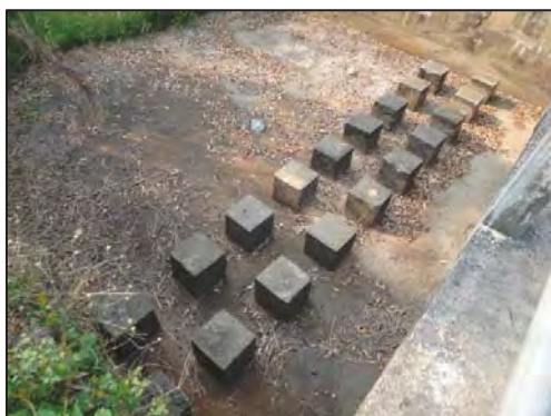
จุดสำรวจโครงการก่อสร้างฝายน้ำล้น ตำบลอ่างทอง พิกัด 548895, 1802130 ลักษณะน้ำแห้งสนิท ดินแห้ง และมีวัชพืชปกคลุม
