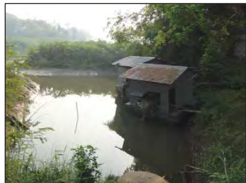
โครงการสูบน้ำด้วยไฟฟ้าบ้านเกาะพิมูล ตำบลเพชรชมพู อำเภอกอสัมปกันคร ปริมาณน้ำต้นทุนเริ่มน้อยลง
