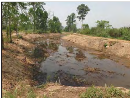
จุดสำรวจคลองสมุย พิกัด 534577, 1811551 มีปริมาณน้ำน้อย แต่สามารถกักเก็บน้ำได้เป็นระยะ เนื่องจากมีการขุดลอกคลอง
