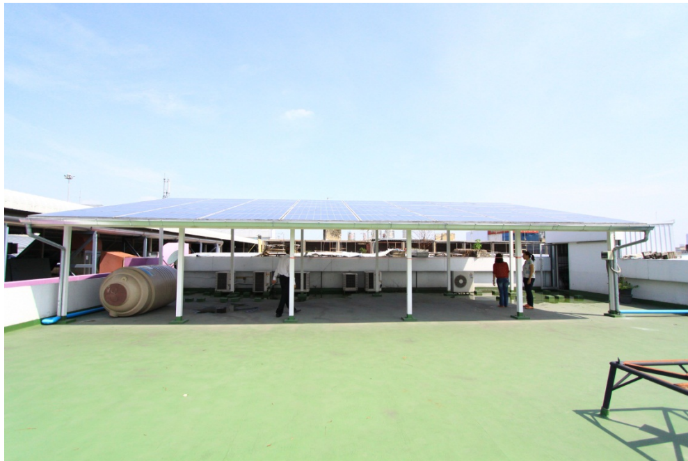
รูปที่ ค-1 โครงการผลิตไฟฟ้าจากแผงรับแสงอาทิตย์ขนาด 11.04 kW ในโครงการที่ศึกษา
