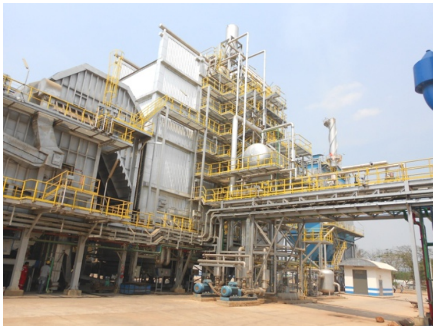
รูปที่ ค-5 โรงไฟฟ้าจากเชื้อเพลิงชีวมวลของบจก. แอ็ดวานซ์ คลีน เพาเวอร์
