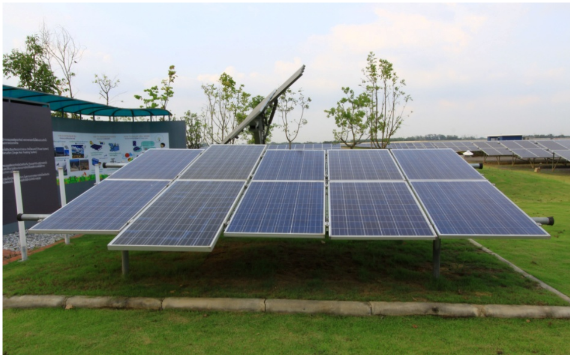
รูปที่ ค-4 ตัวอย่าง Solar PV ของบริษัท บางจากโซล่า การเข้าเยี่ยมชมการผลิตไฟฟ้าจากเชื้อเพลิงชีวมวล
