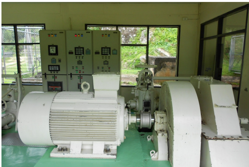
รูปที่ ค-10 โรงไฟฟ้าจากพลังน้ำบ่อแก้ว
