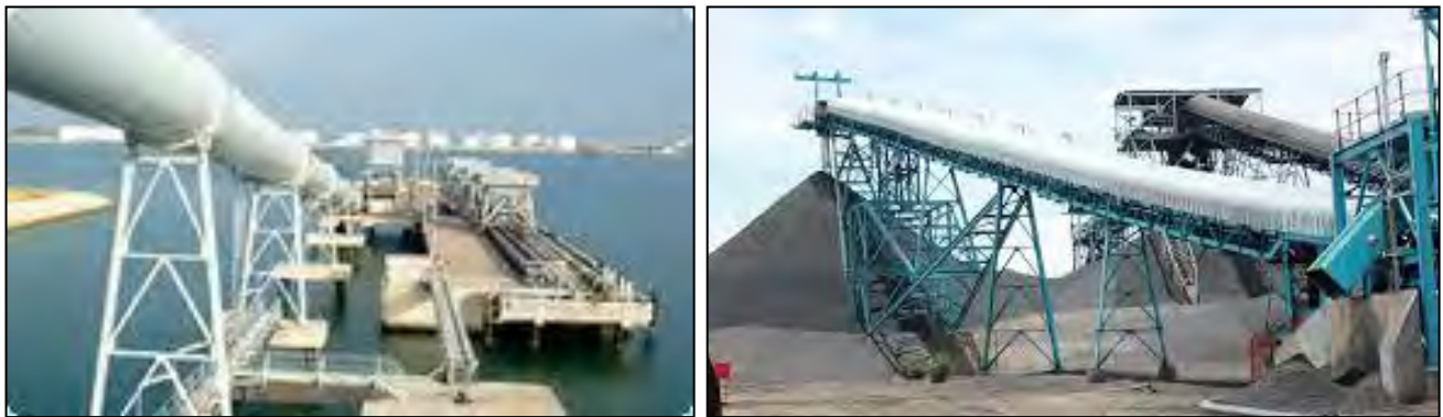
รูปที่ 9-2 การลำเลียงถ่านหินในท่อระบบปิดและในสายพานลำเลียงที่มีหลังคาคลุม [9-6]
