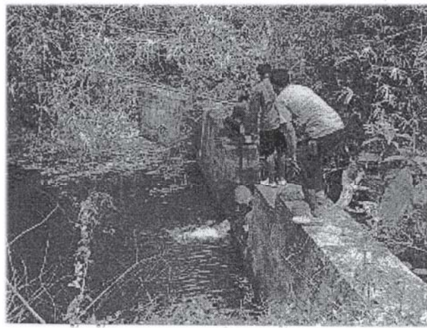
ฝายกั้นน้ำคลองตาย เพื่อผันน้ำเข้านาหมู่ที่ 7
