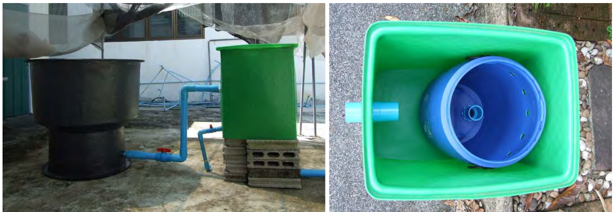
รูปที่ 2-5 ถังแปลงสภาพสารอาหารและควบคุมความเป็นกรดเป็นด่างของสารละลาย
