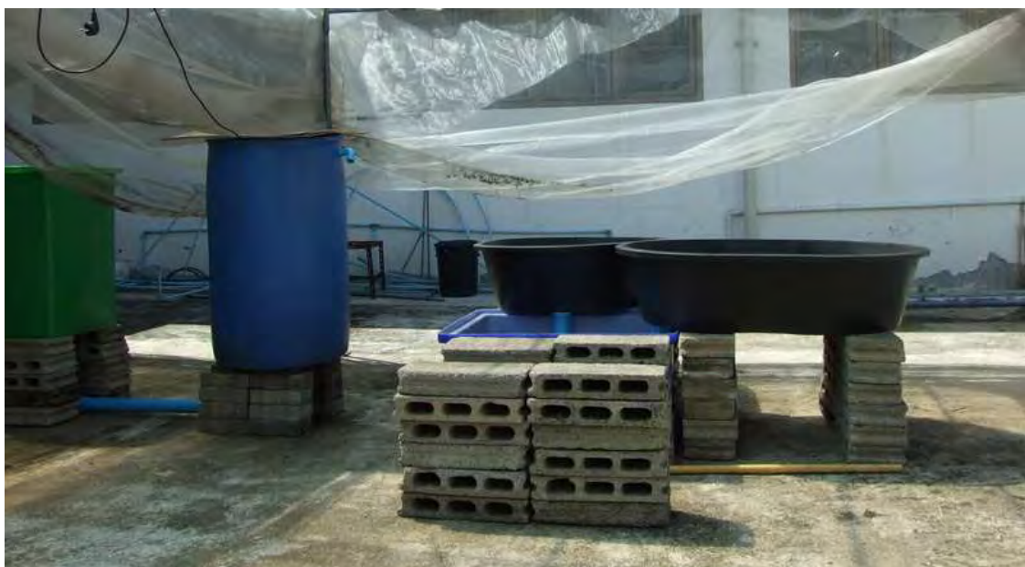
รูปที่ 2-7 ถังกำจัดแก๊สและควบคุมระดับสารละลาย (ถังทรงกระบอกสีน้ำเงิน) ติดตั้งไว้ในโรงเรือนหลังคาที่บึ่งแสง สารละลายไหลเข้าทางด้านล่างของถัง และไหลออกทางด้านบน
