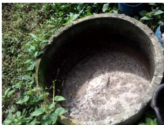
รูปที่ 4-2 บ่อรวมน้ำเสีย
