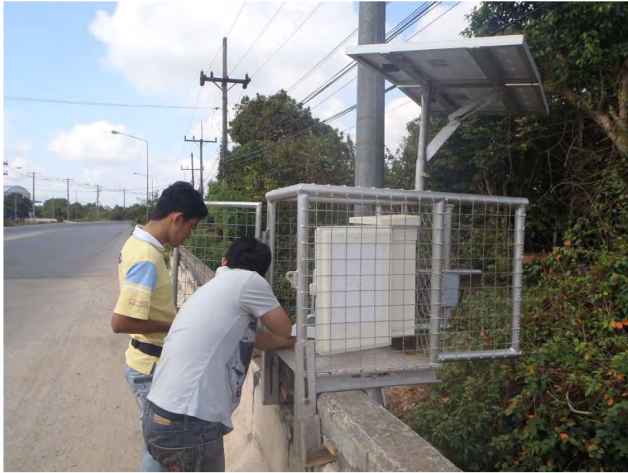
รูปที่ 4.50 สถานีโทรมาตรสะพานคลองลึก ต.บ้านนา อ.จะนะ (NW10)
