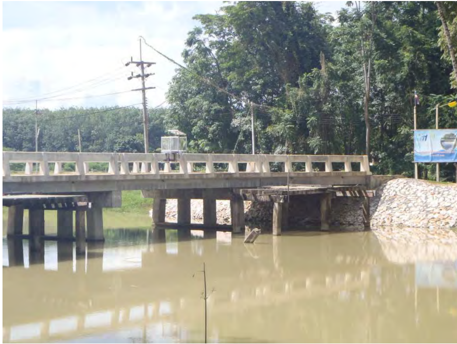
รูปที่ 4.52 สถานีโทรมาตรสะพานฝายชะมวง ต.ท่าชะมวง อ.รัตภูมิ (RP20)
