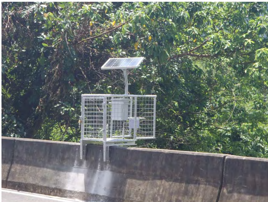
รูปที่ 4.51 สถานีโทรมาตรสะพานบ้านควนดินแดง ต.เขาพระ อ.รัตภูมิ (RP30)
