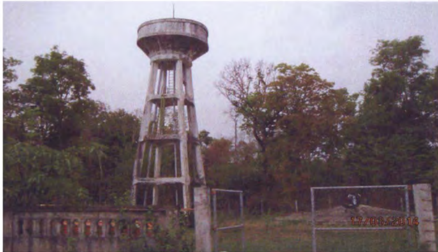
ภาพที่ 54 :ถังพักน้ำและหอส่งน้ำประปาตำบลสร้างคอม
