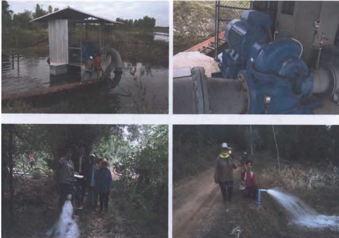
รูปที่ 47 - 50 : ระบบกระจายน้ำอ่างน้ำพาน
