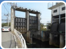
ประตูระบายน้ำปลายลำห้วยหมากแข้ง
