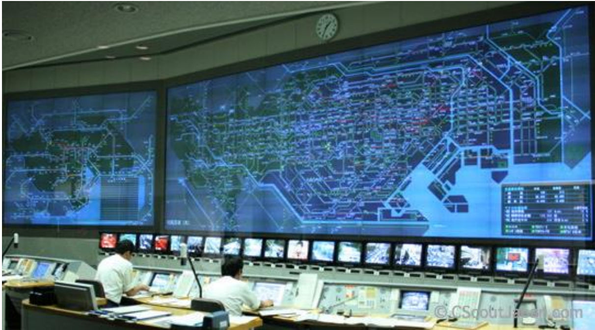
รูปที่ 2.2 ศูนย์ควบคุมการจราจรกรุงโตเกียว (The Tokyo Traffic Control Center) ประเทศญี่ปุ่น ที่มา: Keferi (2007)
