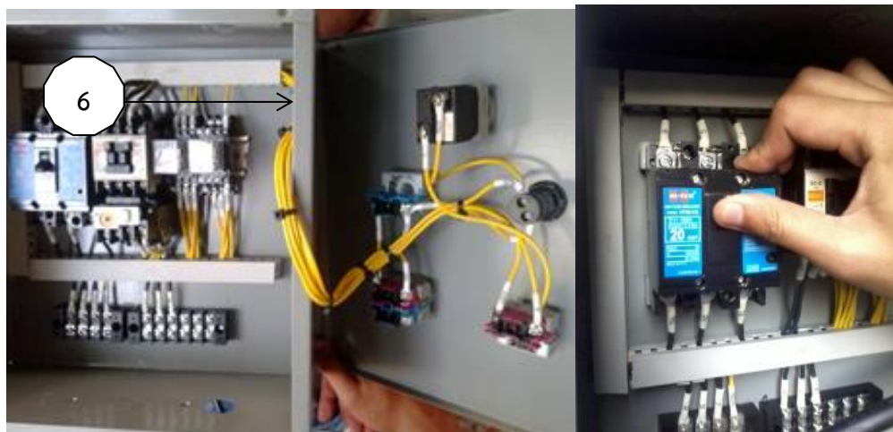
รูปที่ ก.2 ตู้ควบคุมไฟฟ้า
