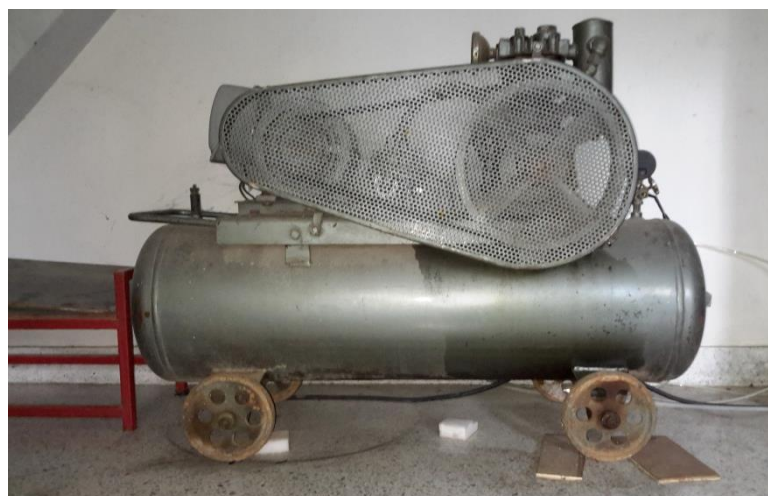
รูปที่ 4-39 ปั๊มลมขนาด 1 Hp
