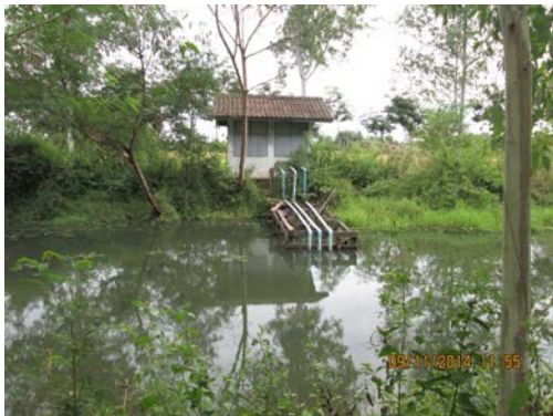
โรงสูบน้ำดิบ
